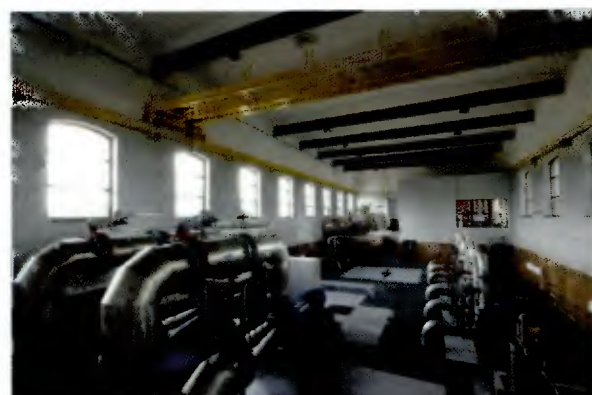
Pompownia II stopnia
