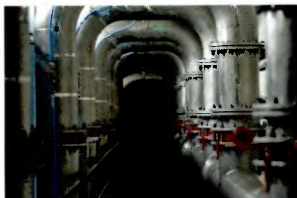
Rurociągi spustowe od klarowników
