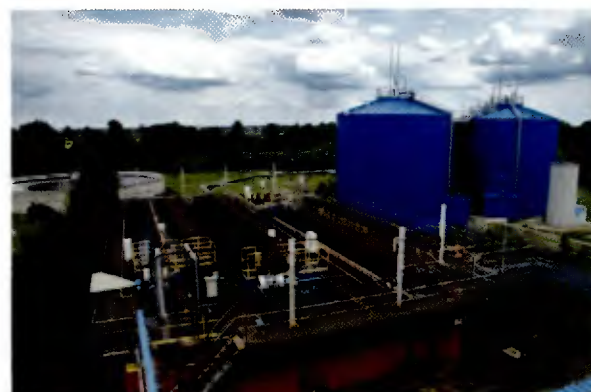
Komory zagęszczania osadu i wydzielone komory fermentacji
